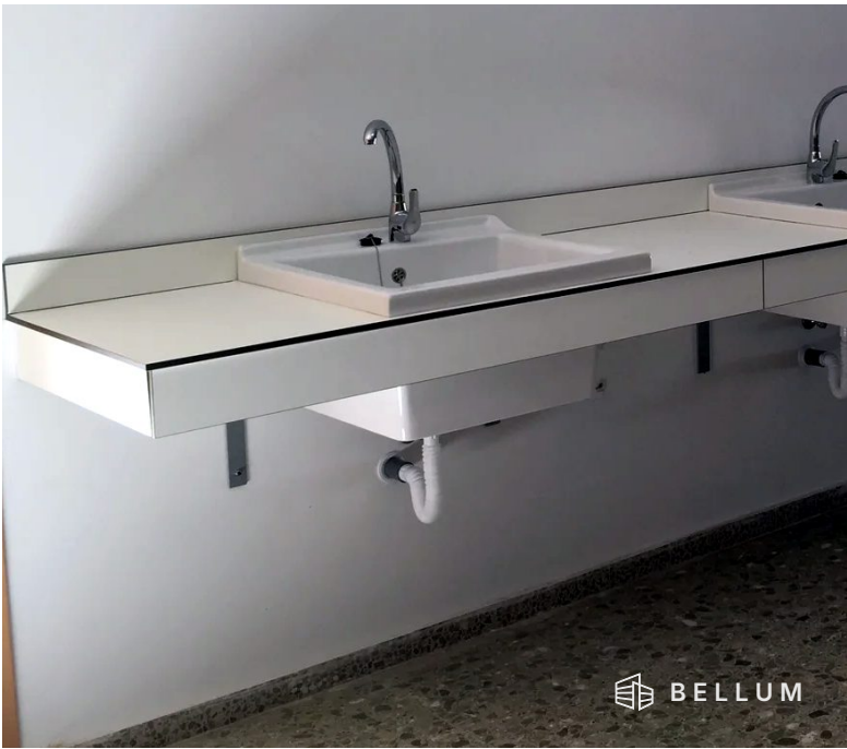
En blanco, sobre escuadras metálicas
